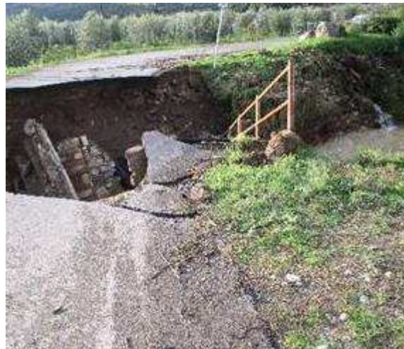
Crollo del ponte visto dalla strada
