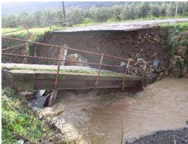
Crollo del ponte visto di lato
